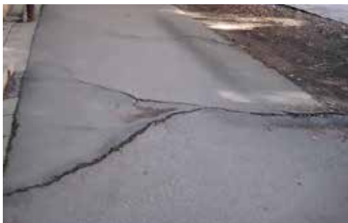
Skador på beläggning orsakade av rötter.
