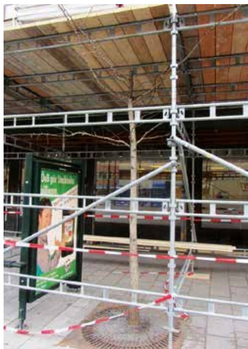
Exempel på skada: trädet har sågats av vid montering av ställning.
